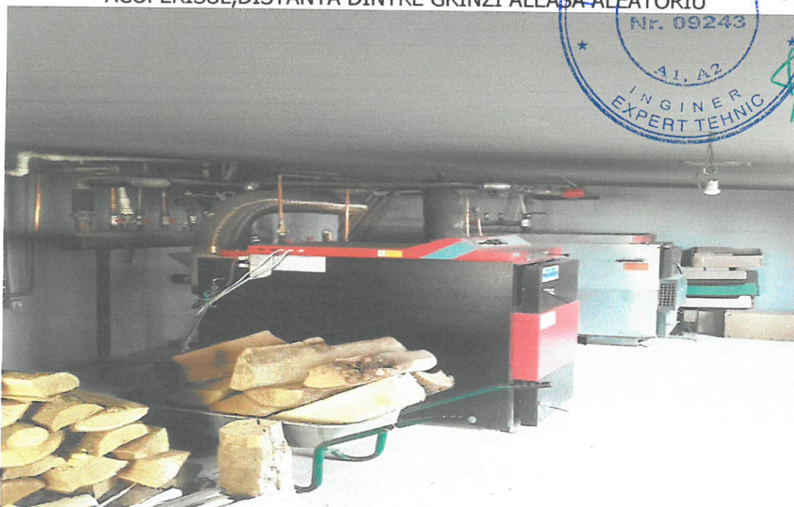
FOTO 2 INALTIMEA INSUFICIENTA LA ACOPERISUL DE PESTE INSTALATII
